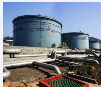
示例10：储罐区围堰破损
